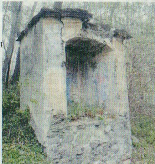
Una delle cappellette che necessitano di restauro a Civo
